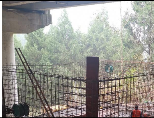
桥梁径流收集工程
