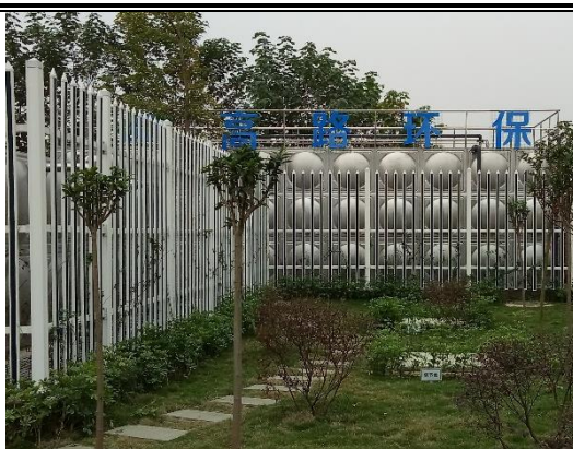
污水处理设备工程
