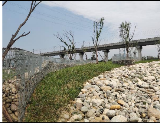
桥梁径流收集工程
