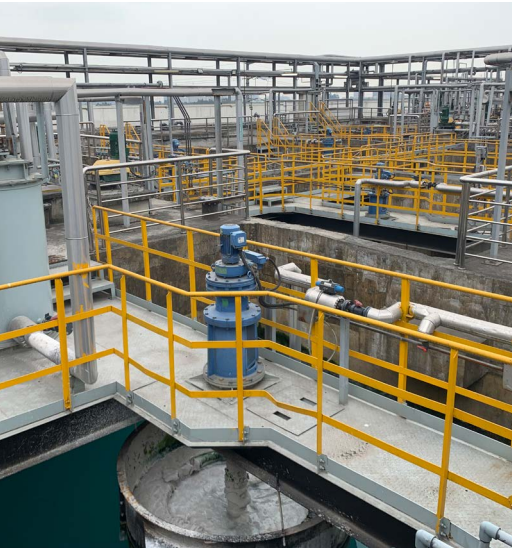
京东方成都第 8.6 代 TFT-LCD 生产线污水处理系统
