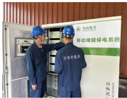
分布式储能项目移动储能保电设备
