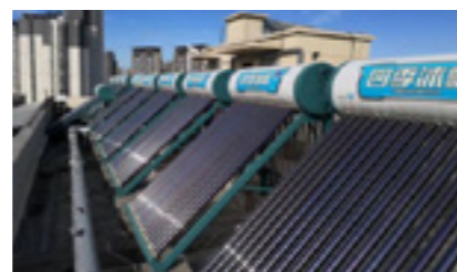
太阳能供水系统
