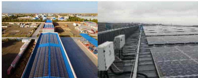
▲ 塔里木钻井光伏发电
