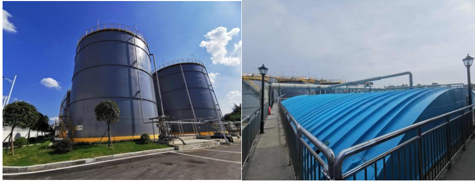
▲ 西南工区工业废水、生活污水集中处理
