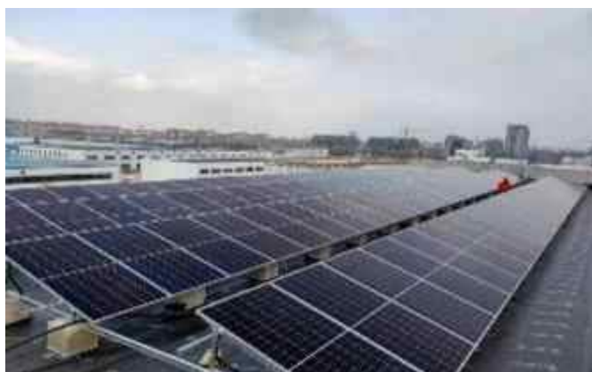
▲ 管具技术服务中心光伏发电
