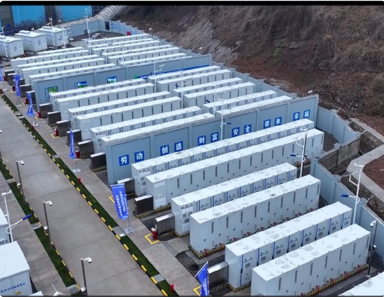
用户侧储能电站
