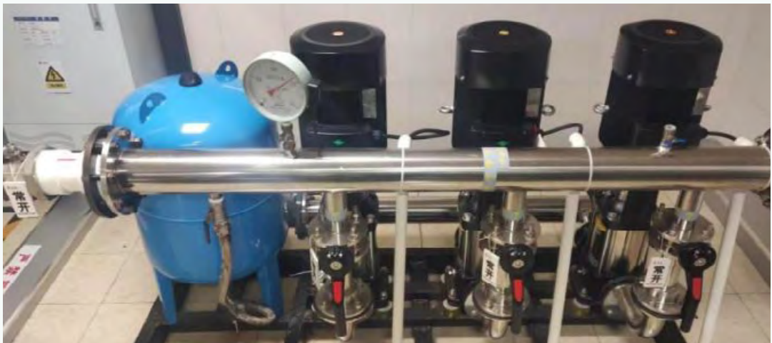
» 中行山西省分行改造办公楼直饮水废水利用系统，该系统投入使用后全年节水量超过 6,500 吨。
