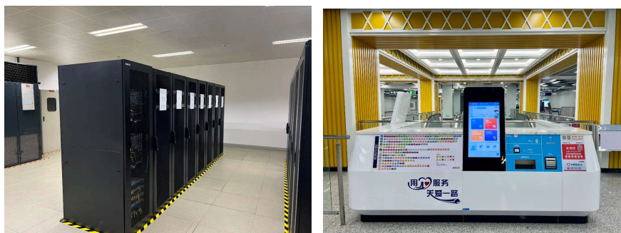
南京地铁 5 号线的云节点机房与智能客服终端
