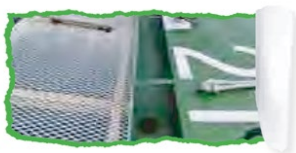
平台直升机甲板收集雨水槽
