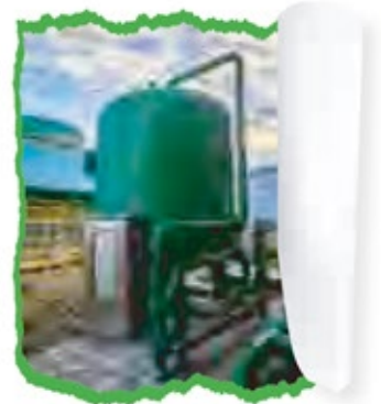
冷却循环水旁滤系统
