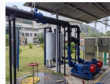
重庆水务厂内中水泵房
