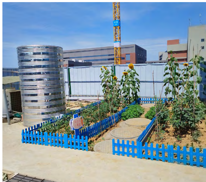
成品化粪池及空气能热水器
