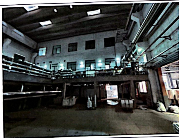
厂房内部照片
